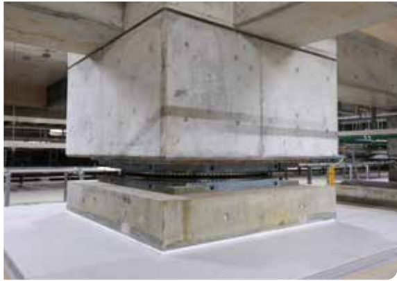
有事の際にも継続した医療提供を行うべく、予想最大震度に対え得る免震構造を取り入れています
